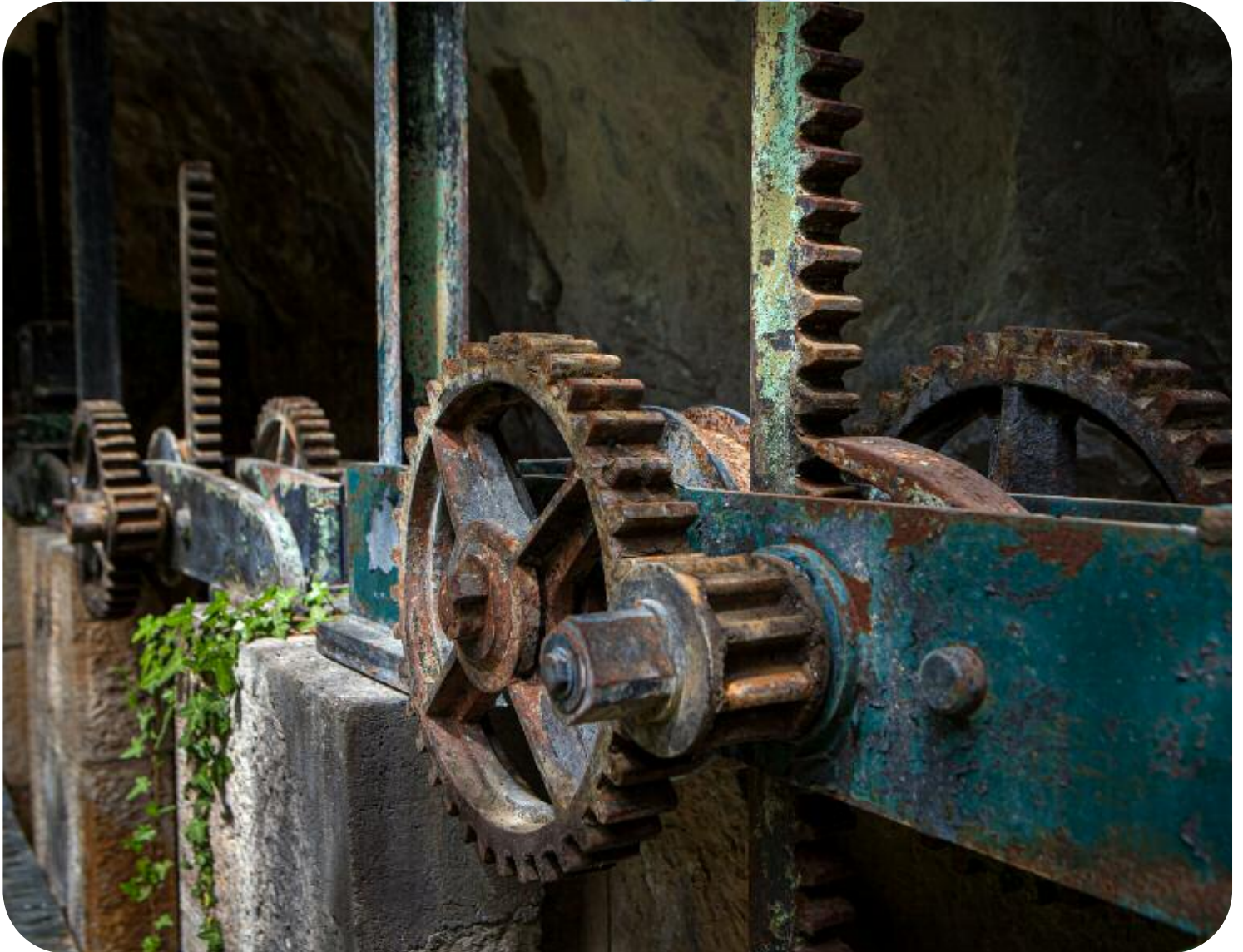
Crémaillères des vannes martelières de la prise d'eau du canal à St-Cézaire-sur-Siagne
