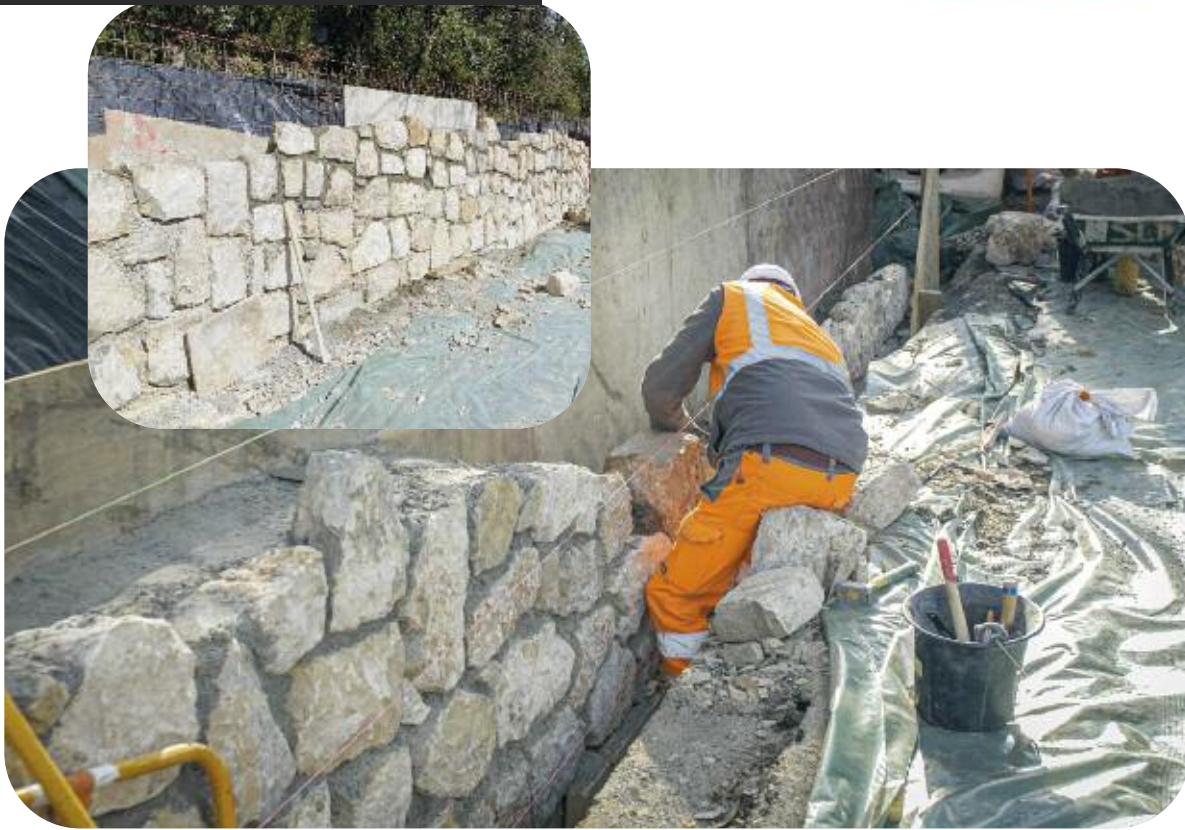
Renouvellement du mur de soutènement du canal de la Siagne, avenue Saint Basile à Mougins
