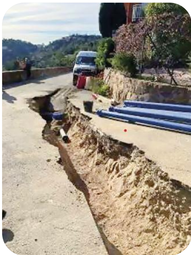
Renouvellement de 700 mètres du réseau d'eau potable, avenue de la Boussole à Théoule-sur-Mer
