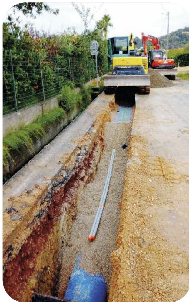
Renouvellement de 500 mètres de feeder DN 500, chemin de la Levade à La Roquette sur Siagne
