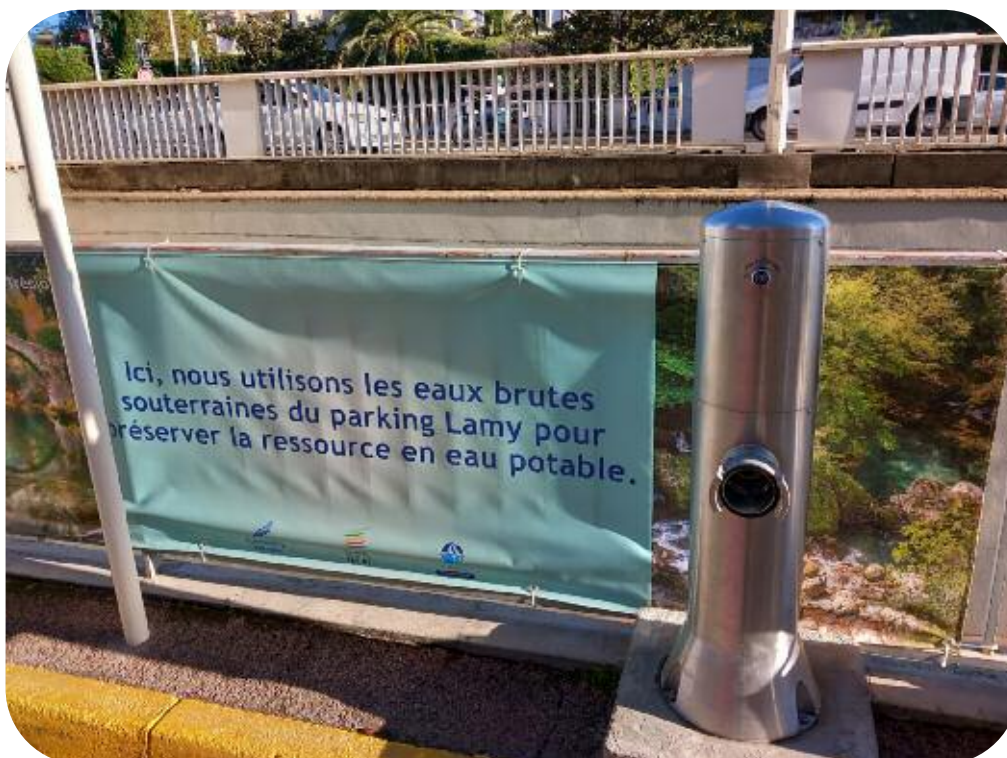
Installation de bornes de puisage des eaux brutes souterraines du Parking Lamy à Cannes
