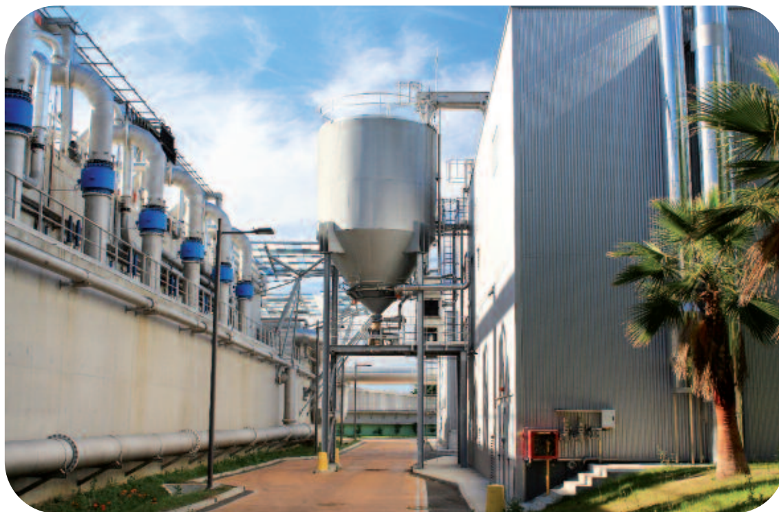
Quai de chargement des boues avec son silo
