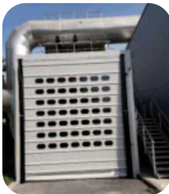
Sas à boues
