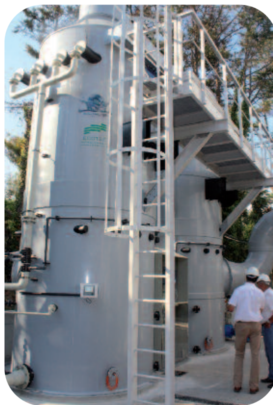
Deuxième ligne de désodorisation créée et mise en service en 2014
