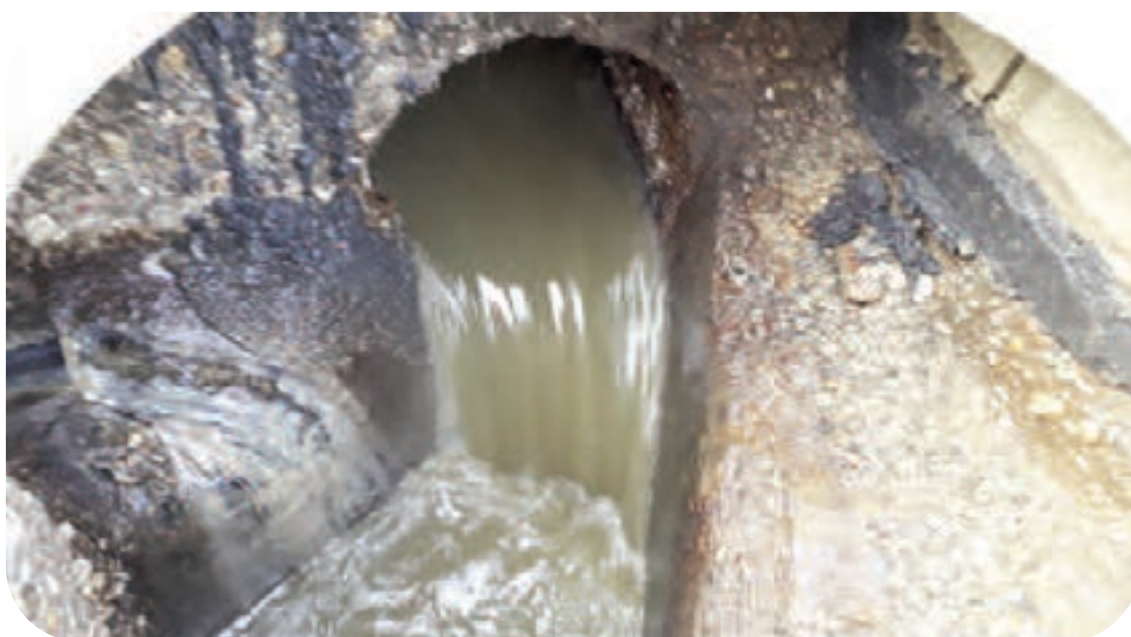
Réseau d'eaux usées
