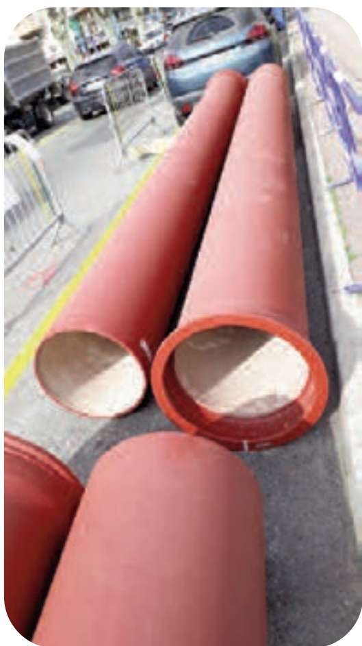
Canalisations de collecte des eaux usées
